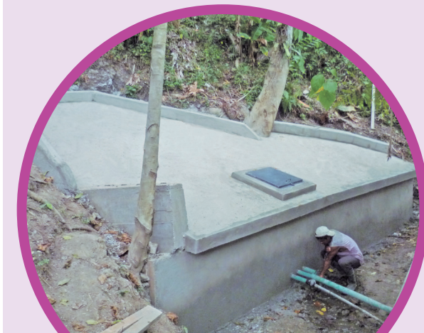
Acueducto ASADA Alto Quetzal de Turrialba.
