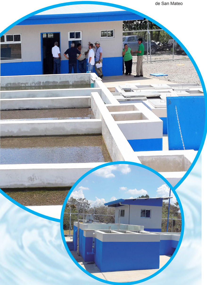
Planta potabilizadora de agua Acueducto de Romacri de San Mateo
